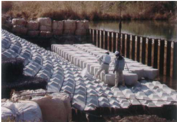
【城原川2t型・根固工／国交省 筑後川河川事務所】
